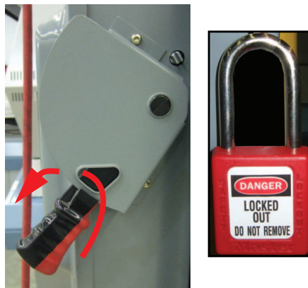
Figura 1-27 Blokowanie głównego wyłącznika prądowego
