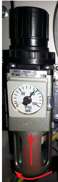
Figura 6-45 Konserwacja oddzielnacza wody
